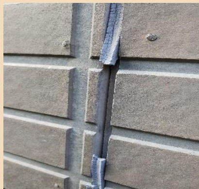
コーキングの亀裂、割れ
