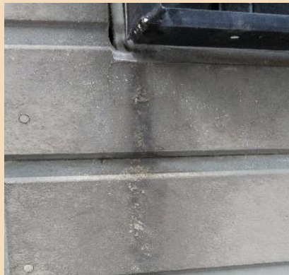
汚れ、表面の剥がれ
